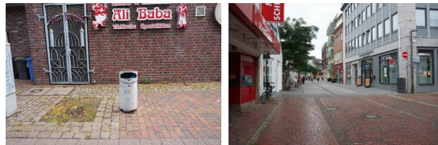
Fehlende Begrünung und unsanierter Straßenbelag im östlichen Teil der Lange Straße Quelle: cima, 2022
